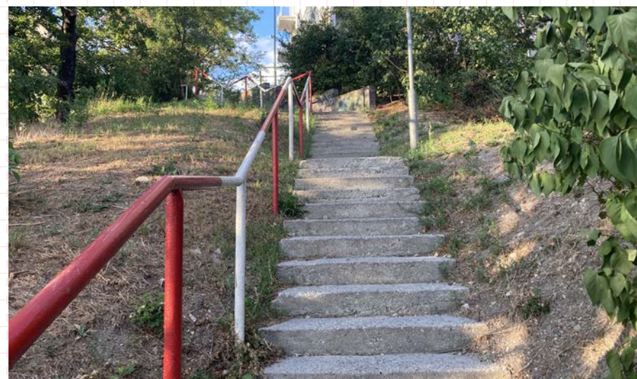
15 Zábradlie umiestnené na okraji terénneho schodiska bez záchytnej funkcie. Bratislava, Kramáre
