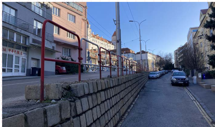
12 Ochranné zábradlie umiestnené na hrane oporného múra. V tomto prípade stiesnených podmienok chodníka, je vhodné zvážiť použitie zábradlia kotveného z jeho vonkajšej strany. Bratislava, Palisády
