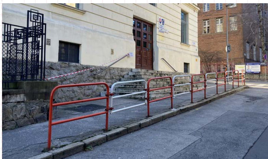
10 Príklad umiestnenia zábradlia pred vstupom do budovy školy s rozptylovým schodiskom. Bratislava, Zochova ulica
