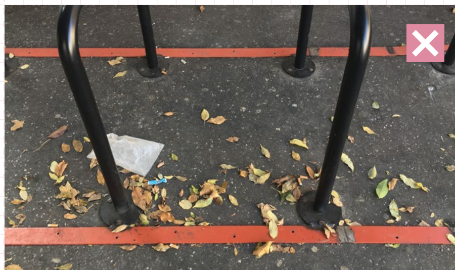
24 Nevhodné povrchové kotvenie cyklostojanov skrutkovaním oceľových pátičiek do asfaltu v kombinácii s navarenými pásovinami.
