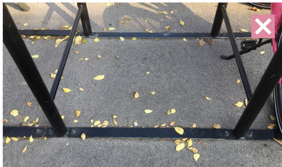
23 Esteticky menej vhodné povrchové kotvenie cyklostojanov pomocou prepojenia jednotlivých stojanov oceľovou pásovinou. Tento typ je nevhodné umiestňovať do historického a kompaktného mesta.
