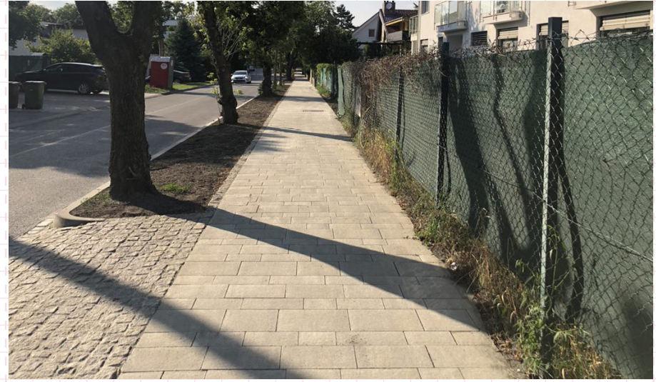
05 Kladenie kamennej dlažobnej kocky do riadku na Škáru a kladenie betónovej dlažby do riadku na väzbu. Bratislava, Prokopa Veľkého
