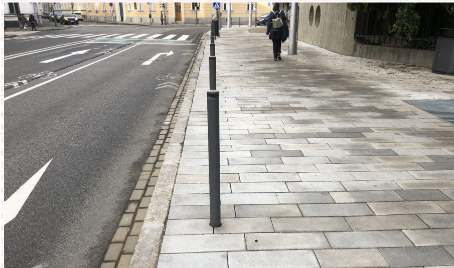
02 Povrch zo žulovej platne s kamenným obrubníkom a s prídlážbou z kerámitu. Bratislava, Mlynské nivy
