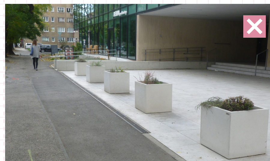
54 Nevhodný detail ukončenia žlabu, ktorý by mal pokračovať pozdĺž celého predpolia budovy, príp. nadväzujúca dlažba by mala mať rovnakú šírku ako žlab. Bratislava, Vajnorská
