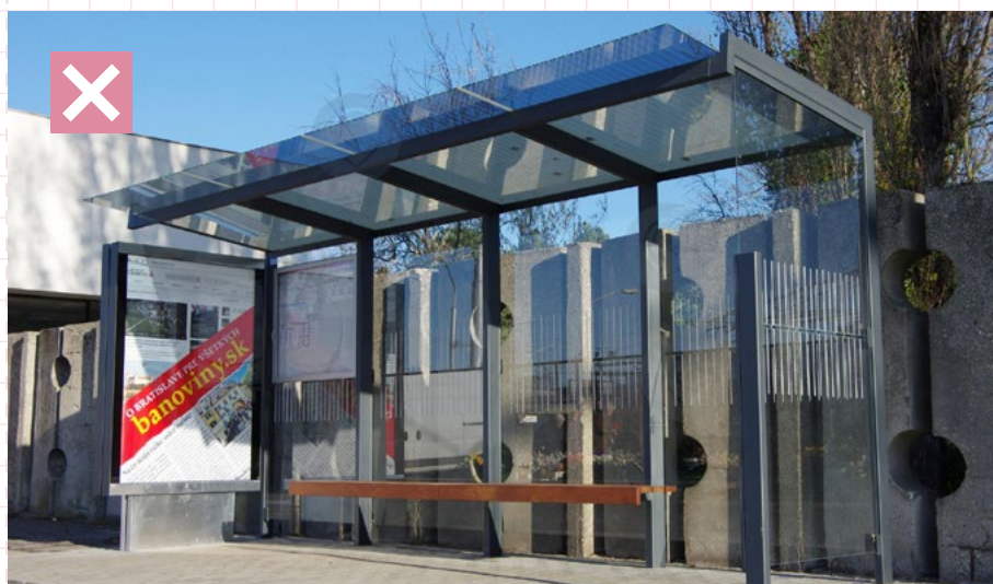
34 Príklad nevhodného umiestnenia prístrešku pri pevnej prekážke na úzkom chodníku. Prístrešok osadený tesne k plotu. Toto riešenie neumožňuje vykonať údržbu, príp. opravu prístrešku ako aj plotu. Bratislava, zastávka Cintorín Vrakuňa
